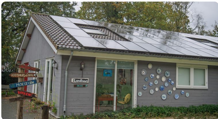
Eine Photovoltaikanlage sorgt für den nötigen Strom im „Landhuus“, dem Café auf diesem Pflegehof.
